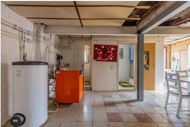
Esszimmer mit Heizungsanlage
